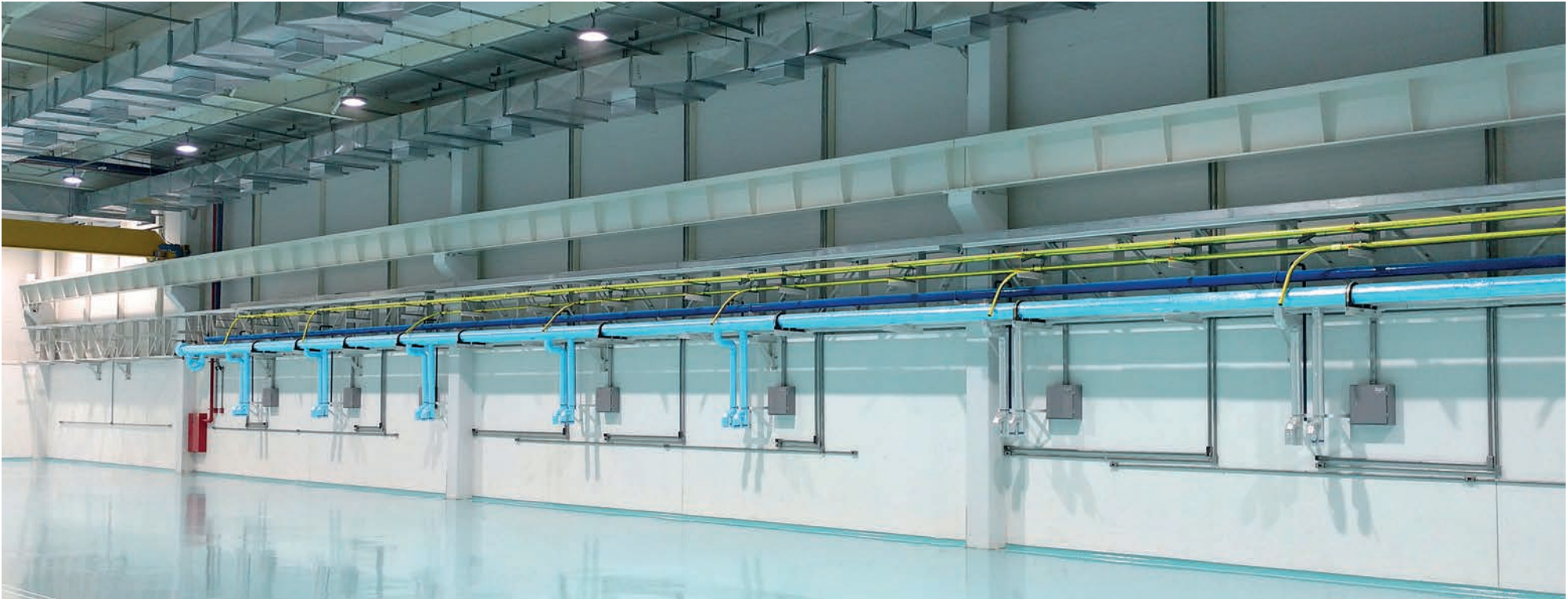
Instalações de um Projeto Turn-key.
